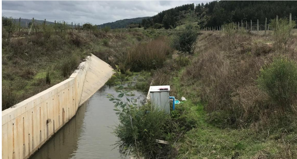
Figura 5. Bomba elevadora eléctrica que extrae aguas del Estero Carrizo.
