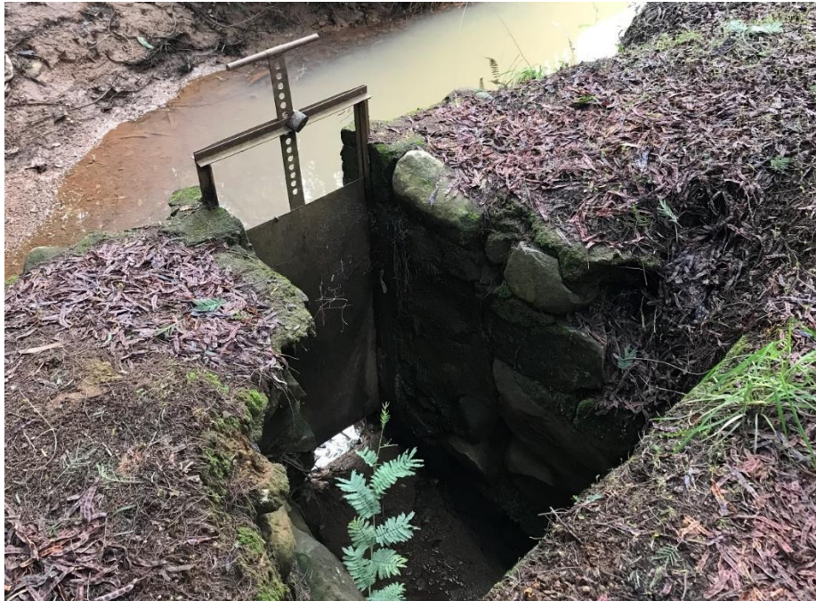
Figura 6. Compuerta canal derivado Rojas Novoa.
