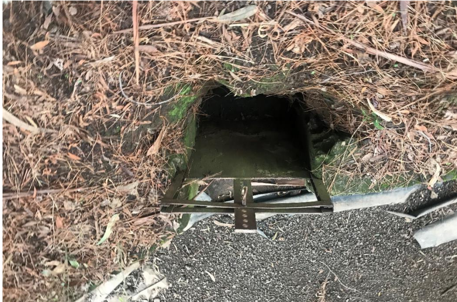
Figura 8. Compuerta canal derivado El Lirio.
