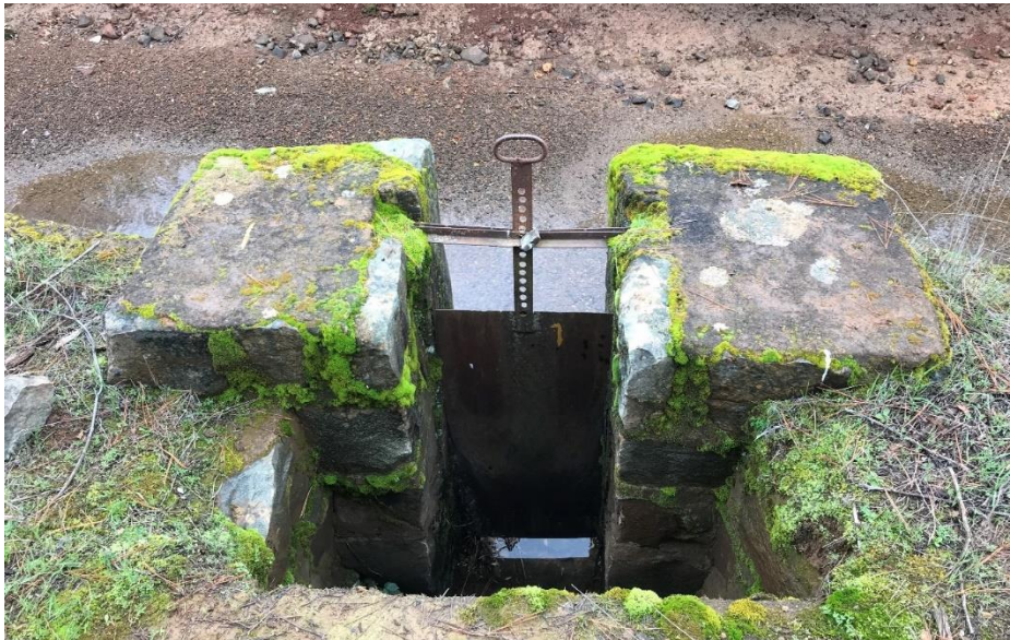
Figura 5. Compuerta canal derivado La Loma.
