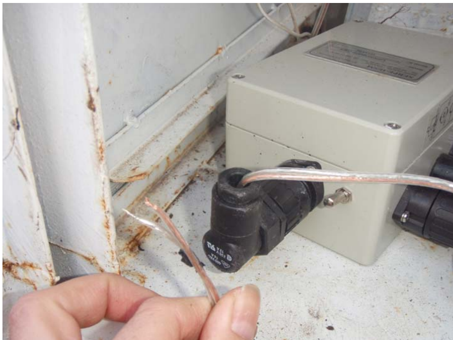
Figura 19. Corte del cable que une la batería al data logger.
