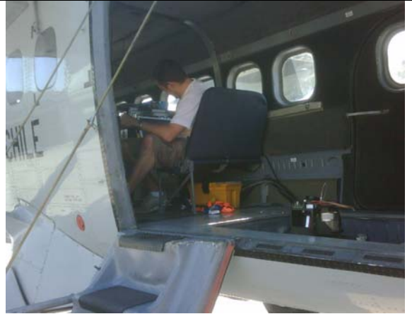
Instalación del sistema Lidar.
