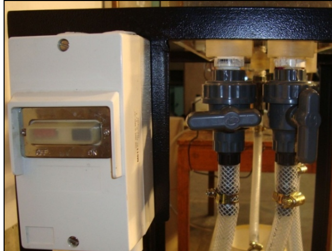
Figura 4.12. Interruptor protector de alzas de voltaje para la bomba.
