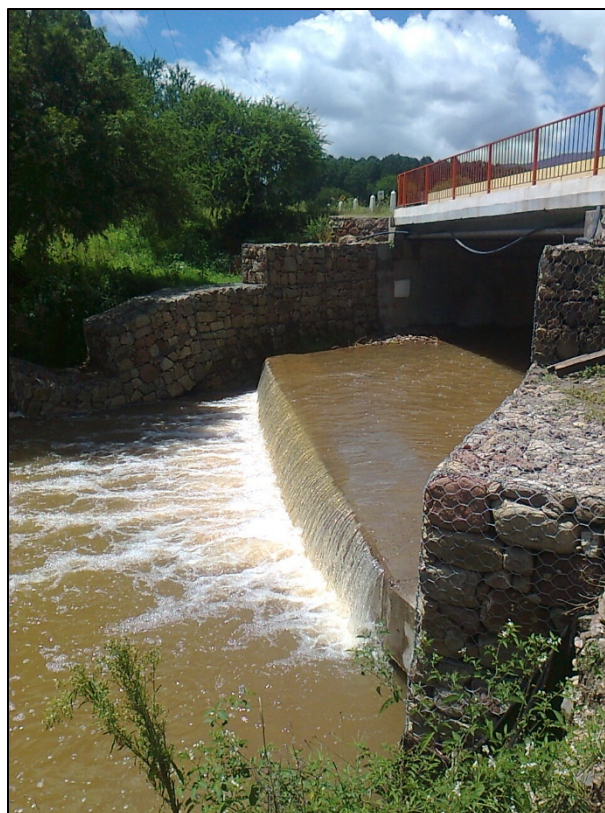
Fig.3: Defensa con Gaviones en Transición de Salida de Puente
