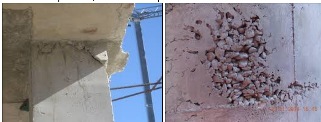
Fig.1: Ejemplos de fisuras y nidos en el hormigón
