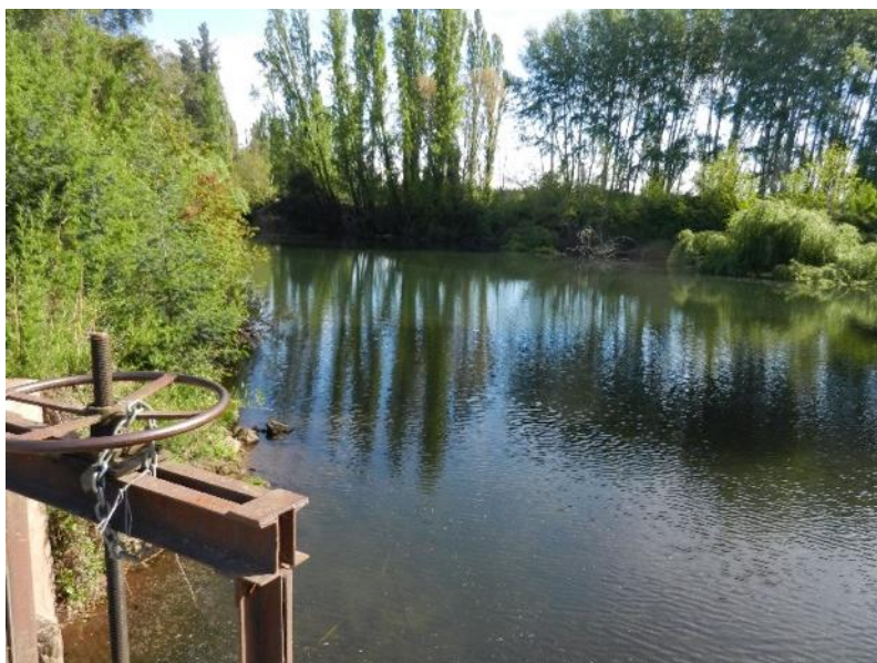
Fotografía 11. Captación canal Casablanca.
