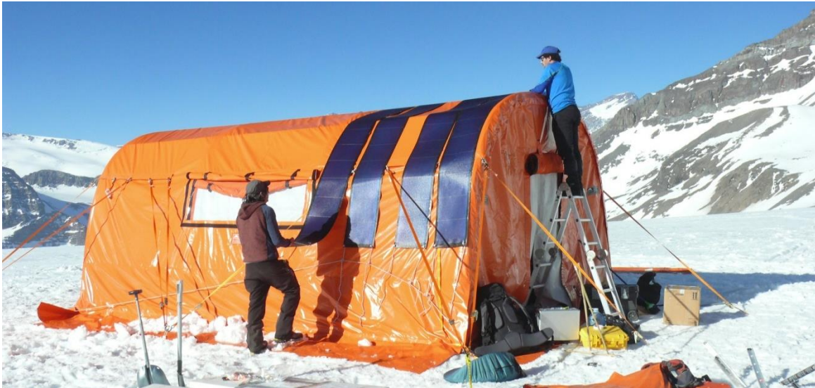
Figura 19: Carpa hangar utilizada por el CETAM para el campamento e instalación de paneles fotovoltaicos flexibles.
