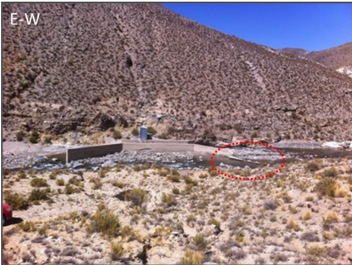
Figura 4. Estación "Río Lauca en Japu" parcialmente destruida. Fuente: elaboración propia.
